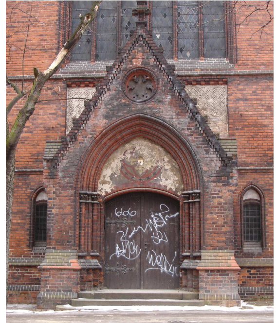
Ansicht eines Seitenportals im geschädigten Vorzustand
