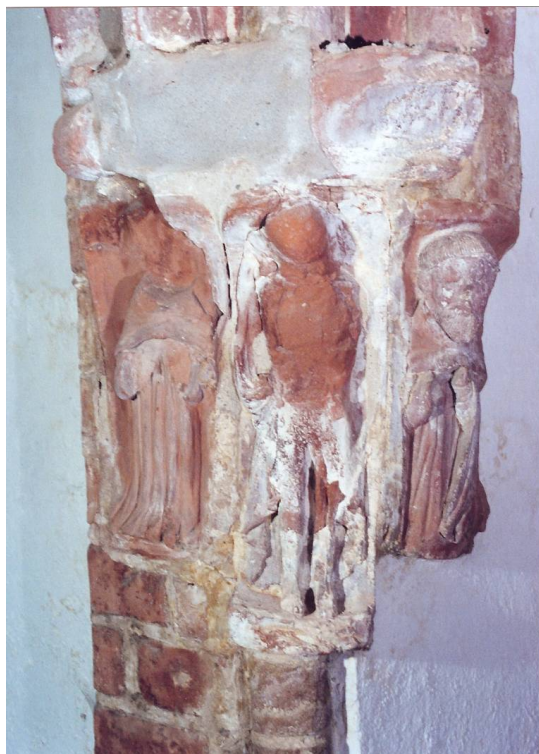
Vorzustand des restaurierten Terrakottakapitells
