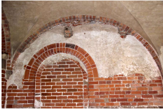
Vorzustand eines konservierten Putzfeldes
