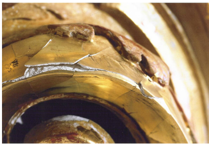
Schadstelle am Deckenstuck; Vorzustand
